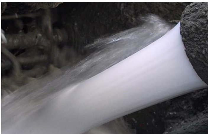
Espuma celular, cemento gris Portland y agua
