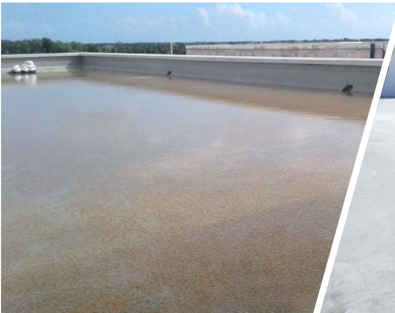
Antes: Superficie sin la pendiente de drenado adecuada
